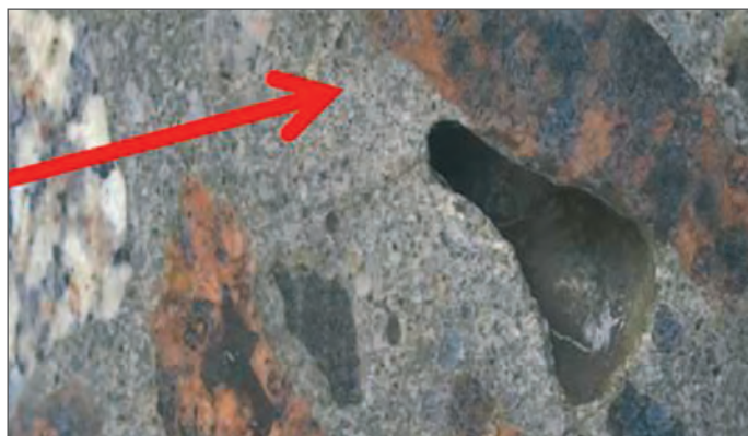
Образование пор в бетоне при применении гранитного щебня с содержанием лещадной формы более 25%
