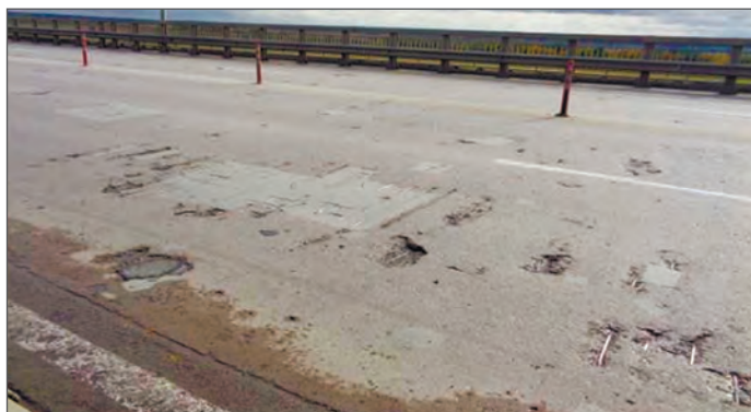
Рис. 3. Состояние цементобетонной дорожной одежды на мосту через Оку после 45 лет эксплуатации
