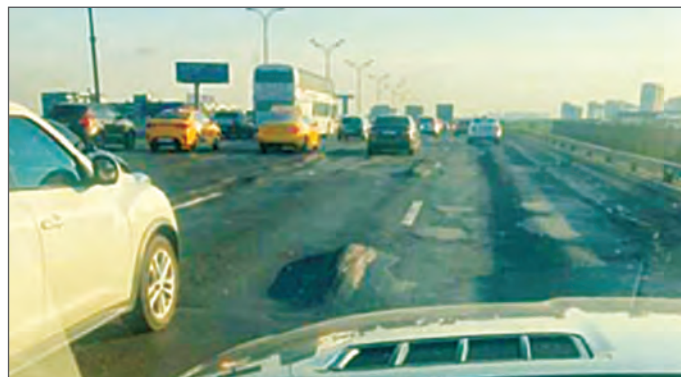
Рис. 4. Состояние покрытия проезжей части из асфальтобетона
