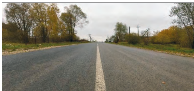
Асфальтобетонное покрытие через 3 года эксплуатации
