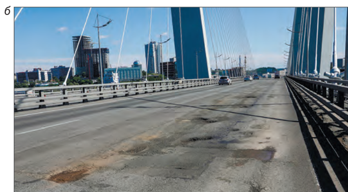
Рис. 1. Состояние покрытия проезжей части мостов в разных регионах РФ
