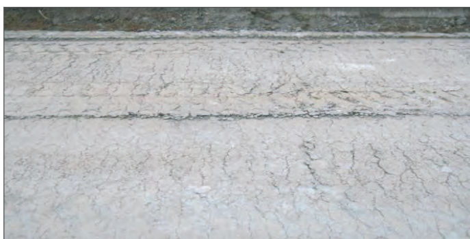
Усадочные трещины на основании
