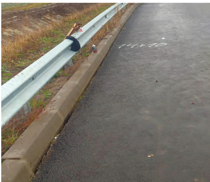
Рис. 2. Трещины вдоль бордюрного камня верный признак сползания откоса
