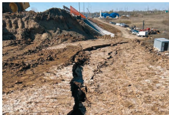
Рис. 3. Сползание откоса снизу на подходе к мосту через р. Юрмаш
