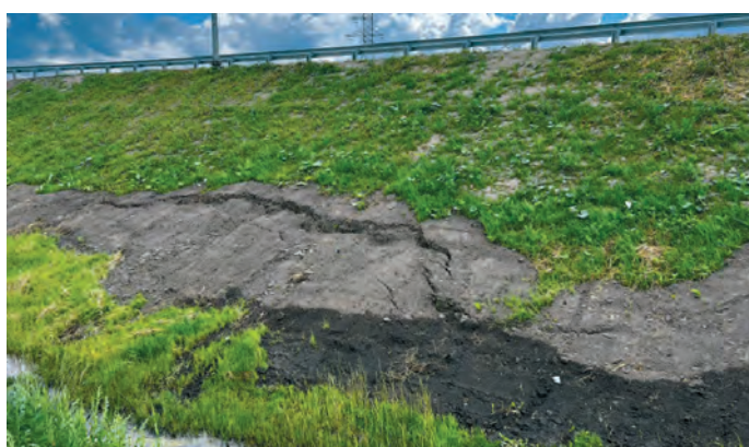
Рис. 8. Разрушение откоса от поступающей воды с противоположной стороны дороги из бывшей мелиоративной сети через 1,5 года после сооружения насыпи
