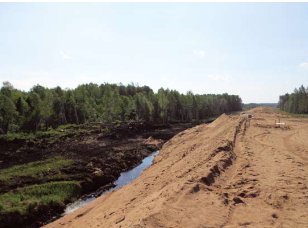
Рис. 2. Вид потери устойчивости основания и обрушение откосов насыпи
