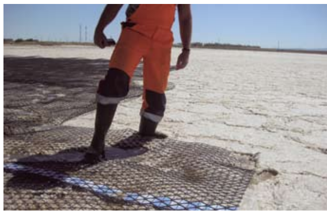
Рис. 4. «Несущая способность» сорово-солончакового грунта
