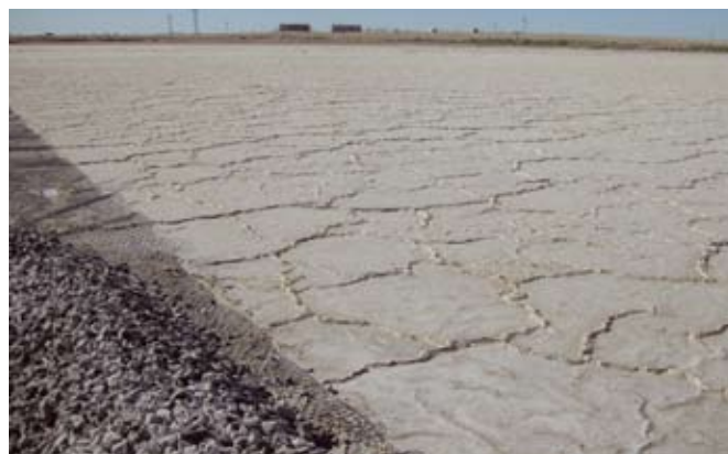
Рис. 2. Засоленная поверхность сорово-солончакового грунта
