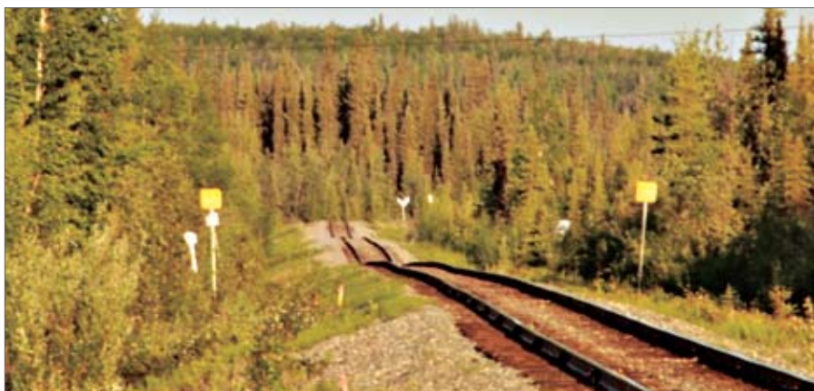
Рис. 5. Деформации земляного полотна Аляскинской железной дороги вследствие развития термокарста (июнь 2008 г.)
