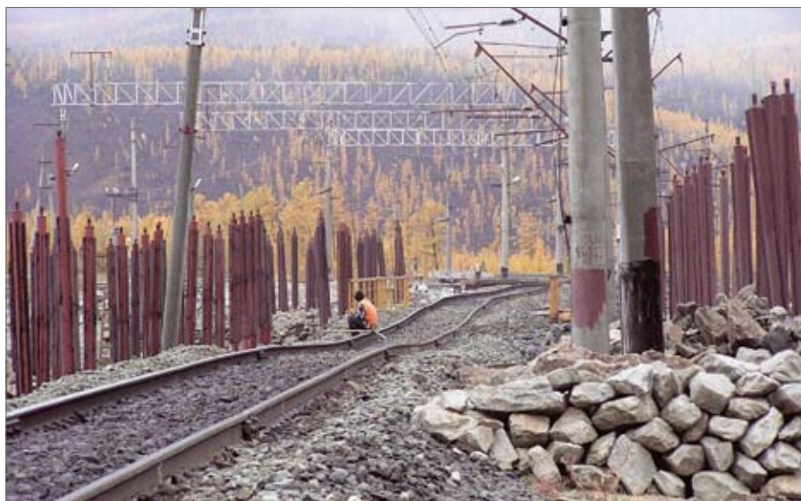
Рис. 2. Участок многолетних деформаций пути и опор контактной сети БАМа, км 1374 (сентябрь 2003 г., фото Е.А. Козыревой)
