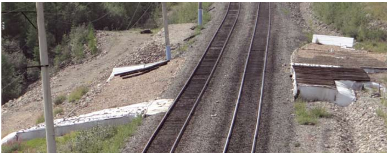
Рис. 9. Солнцезащитные навесы № 1 (справа на рисунке) и № 2 (слева на рисунке) на 1841 км ВСЖД (вид против хода километров, август 2014 г.)
