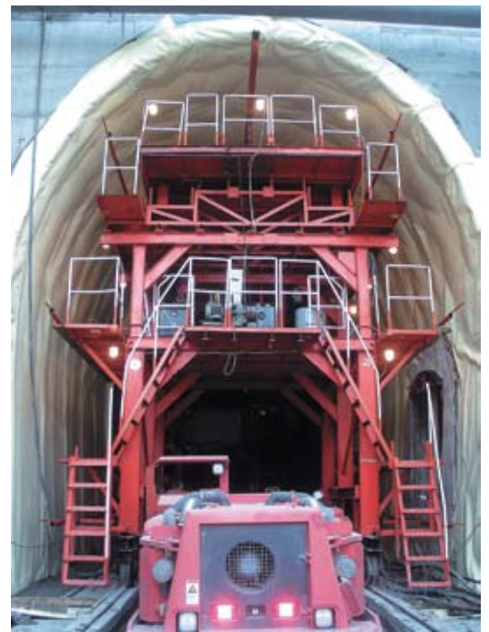
Железнодорожный тоннель №7 в Сочи. Использована система ТН-ТОННЕЛЬ Барьер
