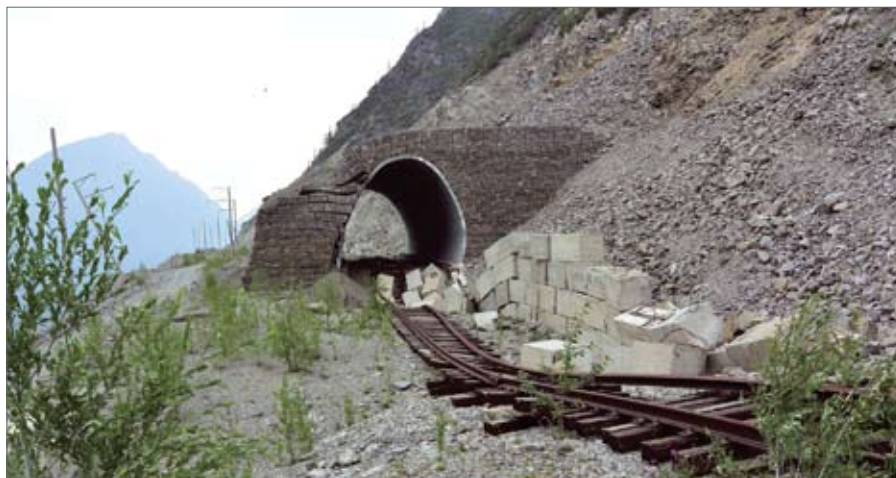
Рис. 3. Разрушение подъездного железнодорожного пути Чара — Чина геологическими и геокриологическими процессами и явлениями (июль 2015 г.)
