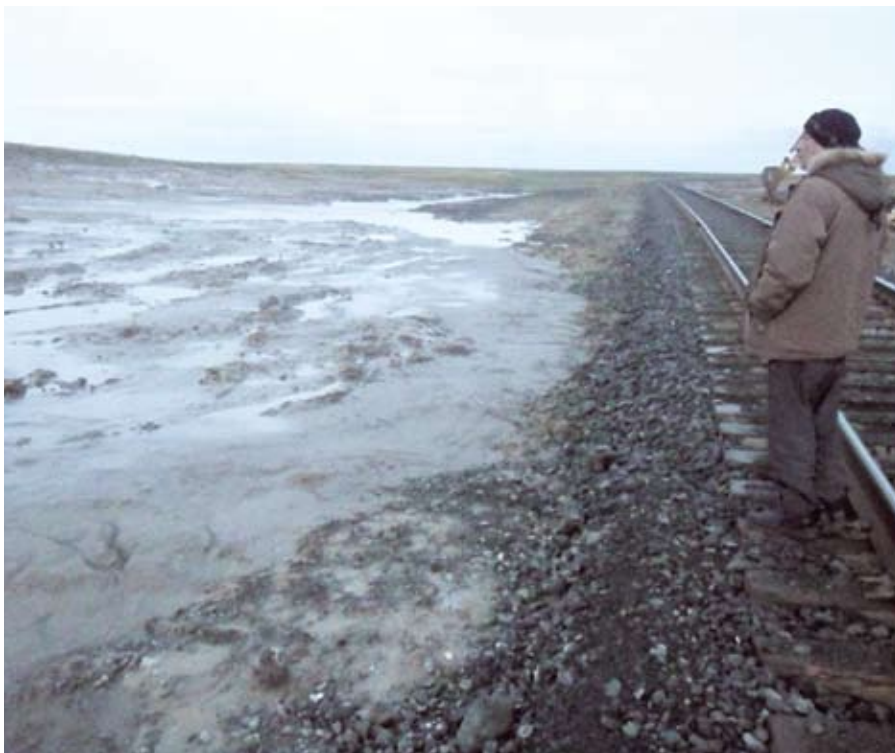
Рис. 3. Сплыв откоса выемки на км 537
