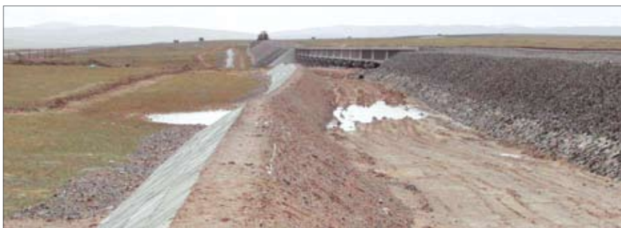
Рис. 6. Деформации земляного полотна Цинхай-Тибетской железной дороги вследствие развития термокарста (август 2004 г.)
