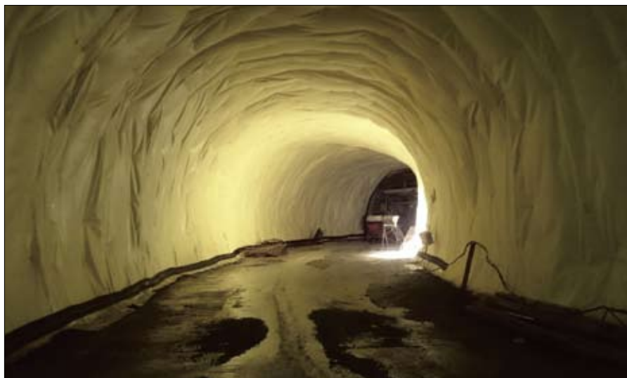
Тоннель в составе комплекса Рокского тоннеля. Использована система ТН-ТОННЕЛЬ Дренаж
