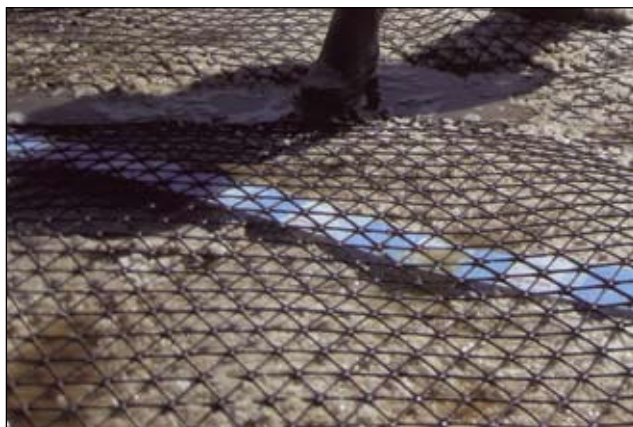
Рис. 4. «Несущая способность» сорово-солончакового грунта
