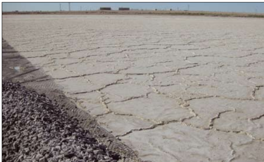
Рис. 2. Засоленная поверхность сорово-солончакового грунта
