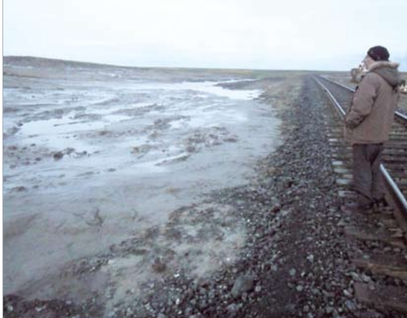
Рис. 3. Сплыв откоса выемки на км 537
