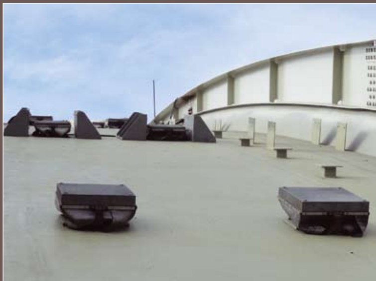
Пылезащитные опорные части на арке под теплотрассу в Санкт-Петербурге
