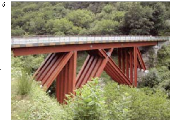
Рис. 4. Подкосный балочный мост в Мерле: а — поперечный разрез пролетного строения; б — вид с фасада
