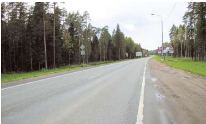
Рис. 5. Общий вид испытательного участка после четырех лет эксплуатации
