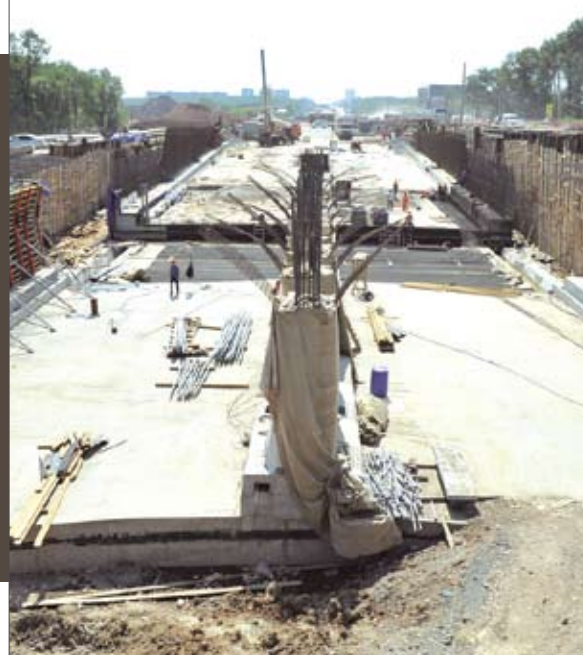
Готовый участок плиты проезжей части южной ramпы путепровода тоннельного типа на пересечении Московского и Ракитовского шоссе
