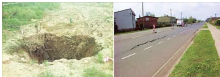
Рис. 2. Провал на участке производства работ и оседание поверхности на существующей трассе
