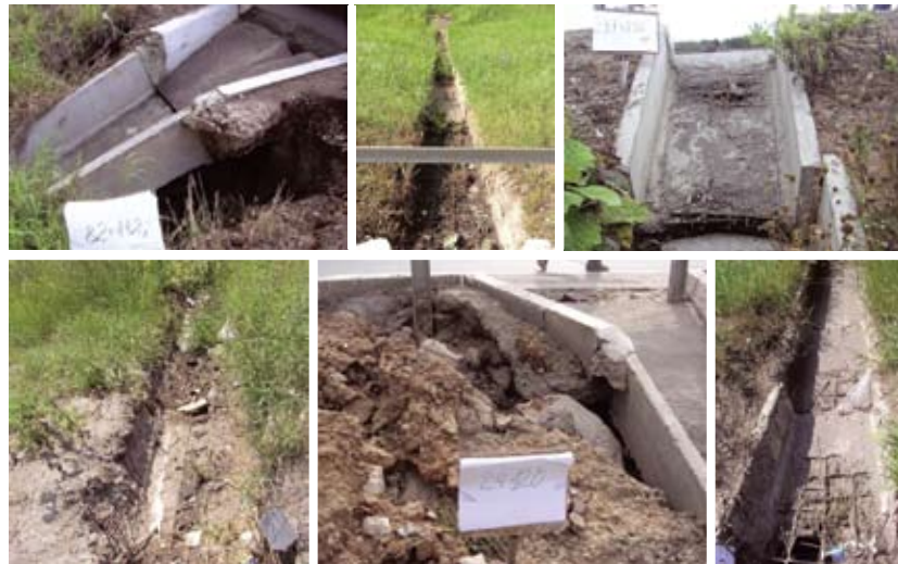
Рис. 6. Состояние телескопического лотка на новой дороге
