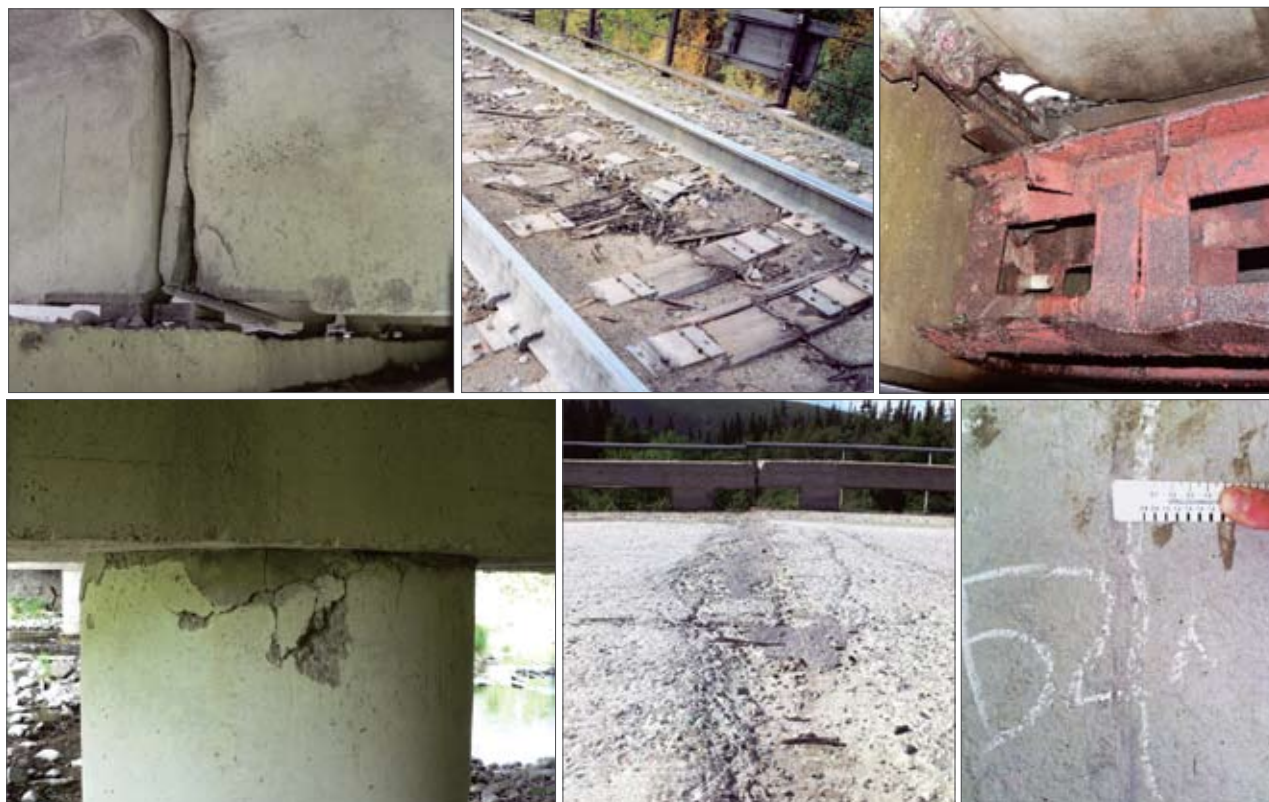
Рис. 3. Характерные дефекты обследованных мостов
