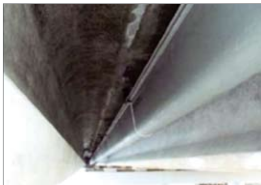
Подвесной композитный лоток между балками пролетного строения
