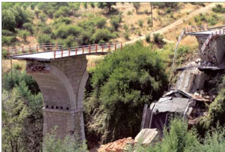
Пример разрушения моста при землетрясении
