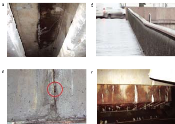
Рис. 2. Наиболее значимые дефекты и повреждения: а — протечки через плиту; б — перелом продольного профиля; в — разрушение стыка диафрагмы; г — коррозия противовеса
