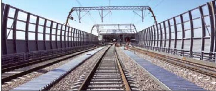
Эстакада. Вид изнутри. Шумозащитные экраны
