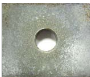
Рис. 4. Контактная поверхность образца с покрытием ЦВЭС-А после ускоренных климатических испытаний в течение 105 циклов (15 лет). Белый налет — продукты коррозии цинка
