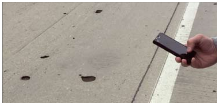
Дефекты на дороге Астана — Караганда
