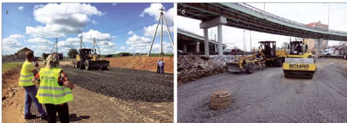
Рис. 5. Укладка морозозащитного слоя из пеностекляного щебня: а – транспортная развязка на дороге М-3 «Украина» (Калужская область), б – транспортная развязка на дороге М-5 «Урал» (Рязанское шоссе, г. Люберцы)
