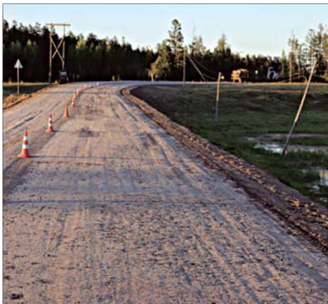
Участки обводненных дорог до (а) и после (б) стабилизации и укрепления грунта
