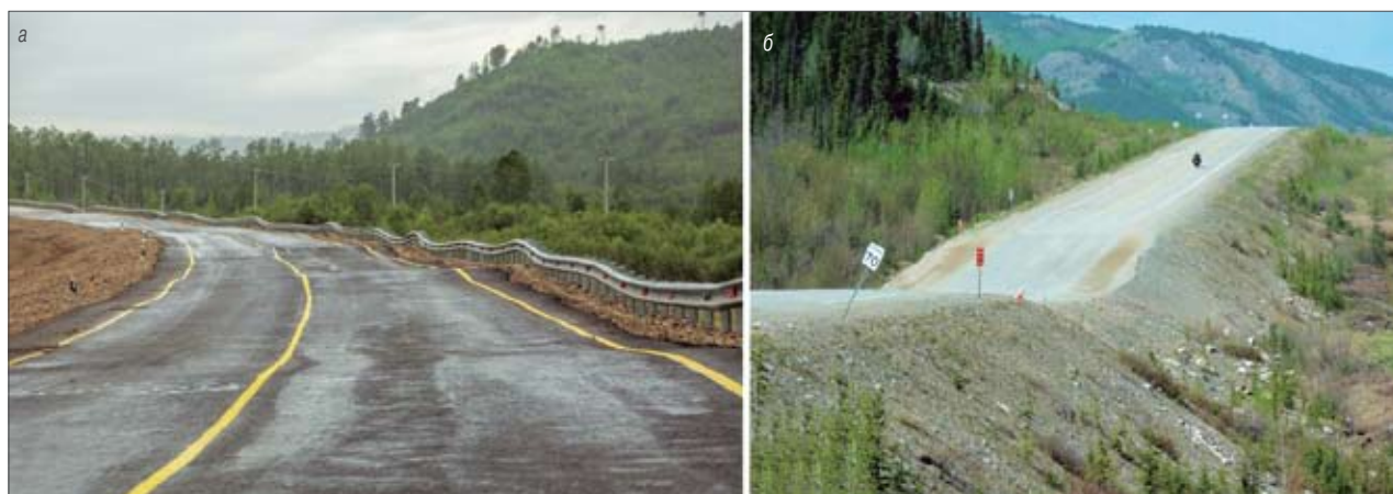
Рис. 1. Неравномерная осадка насыпи на ММГ: а — трасса Р-297 «Амур» Чита — Хабаровск, б — шоссе на Аляске
