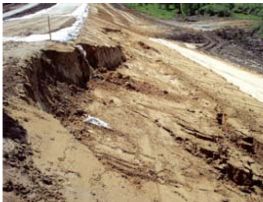
Сползание грунтов с откосов земляного полотна в процессе строительства
