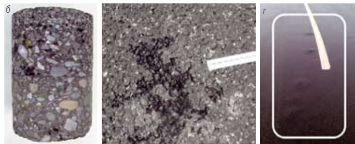
Недостатки стандартных видов асфальтобетонных покрытий: а – деформации; б – неоднородная смесь; в – водная иммерсия; г – вспучивание
