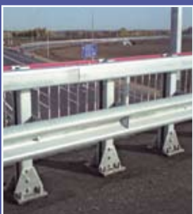
Одностороннее барьерное ограждение с применением балок типа «W» и «С» на мостовом переходе трассы М-7 «Волга» (г. Казань)
