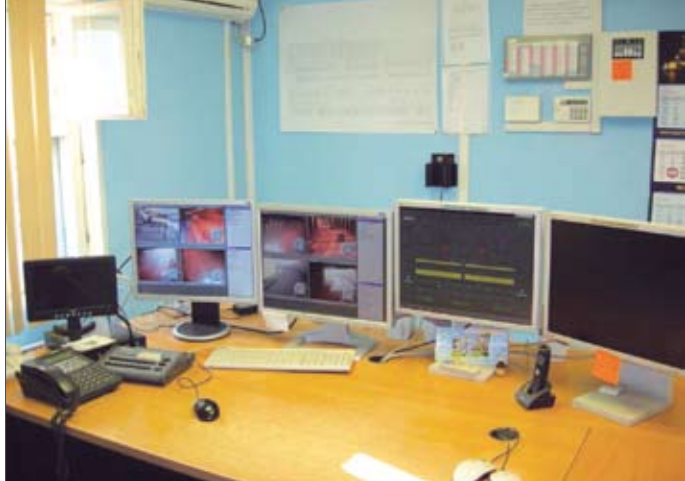
Рис. 5. Система видеонаблюдения и охраны в Канонерском транспортном тоннеле
