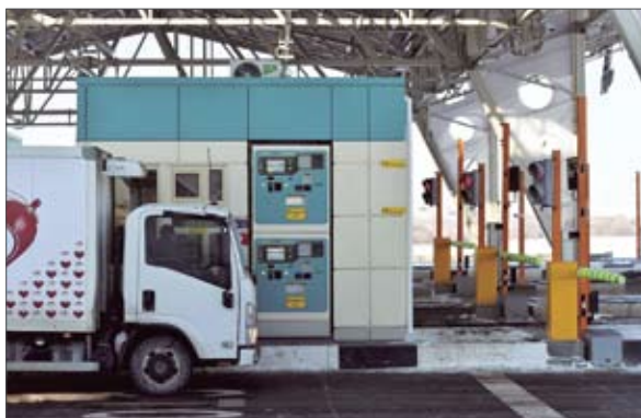
ПВП на объекте в Камбарке. СВП SharpToll
