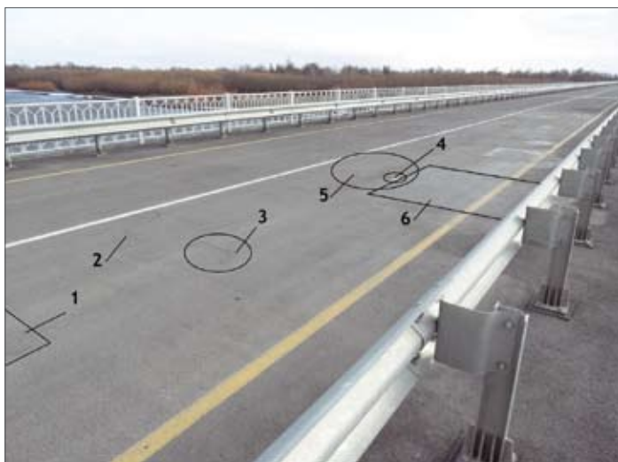
Износ дорожной одежды моста через р. Камчатку
