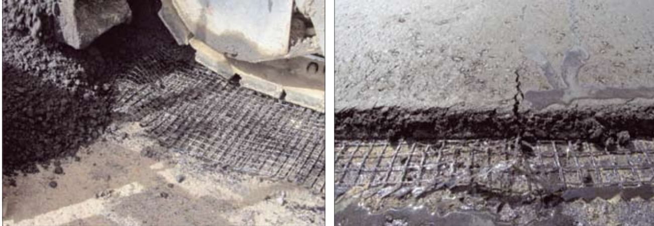
Рис. 3. Заломы на армирующей прослойке при укладке асфальтобетонной смеси
