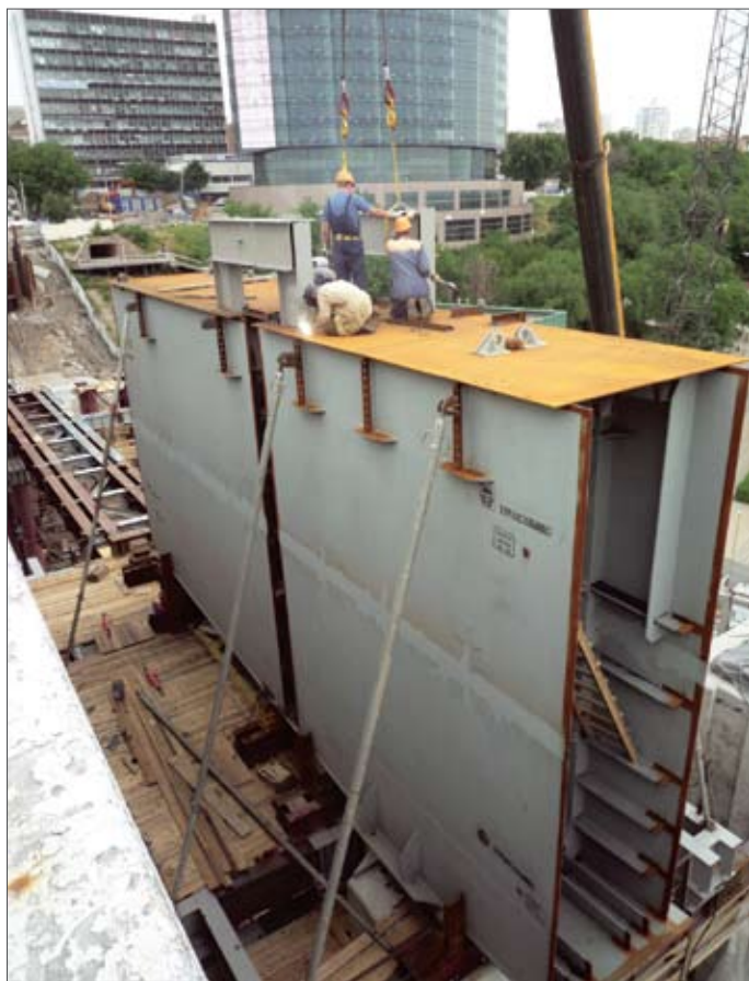
Рис. 1. Установка шпренгелей для сварки первого стыка опорного блока высотой 6,8 м главной балки пролетного строения. Ворошиловский мост в Ростове-на-Дону
