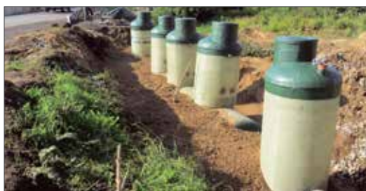
Рис. 8. Установки модульного типа
