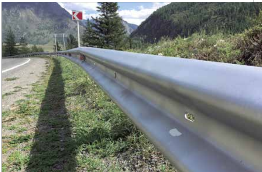
Защита барьерного ограждения
