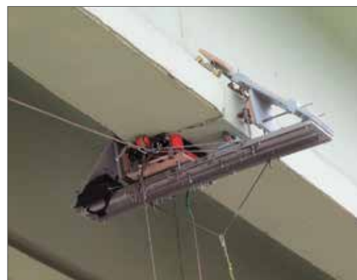
Рис. 8. Неразрушающий контроль преднапряженных балок пролетных строений МС при помощи магнитного дефектоскопа «Интрос»
