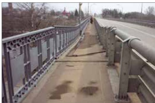
Просевшее пролетное строение – проезжая часть
