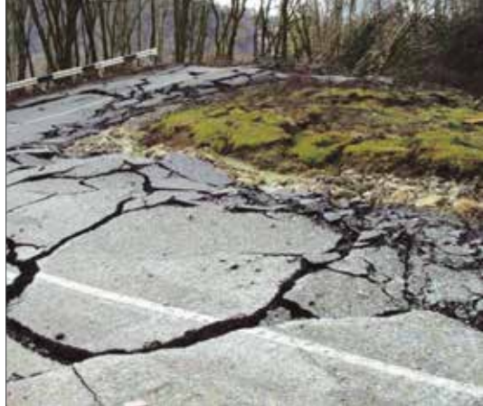
Рис. 1. Оползень на км 6 автомобильной дороги Хоста — Верхняя Хоста
