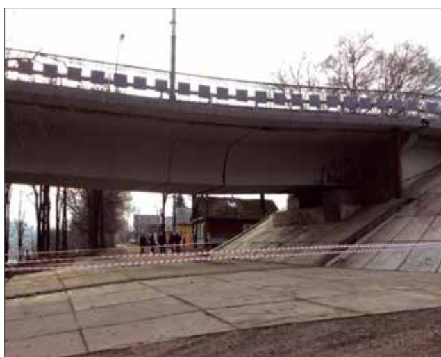
В пролете 5-6 произошло разрушение стыков Б3-Б4 и Б4-Б5 с образованием глубокого провисания блока Б4
