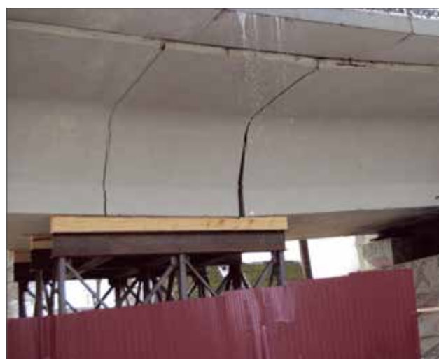
Под «просевший» блок была подведена страховочная опора из прокатного металла
