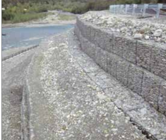
Рис. 2. Габрионное берегоукрепление на р. Псеузапсе для защиты участка автодороги Лазаревское — Тхагапш
