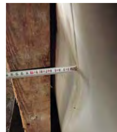
Рис. 9. Потеря устойчивости, зафиксированная при обследовании мостового сооружения
