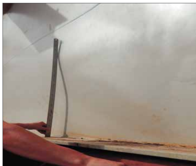
Рис. 7. Потеря устойчивости, зафиксированная при обследовании мостового сооружения
