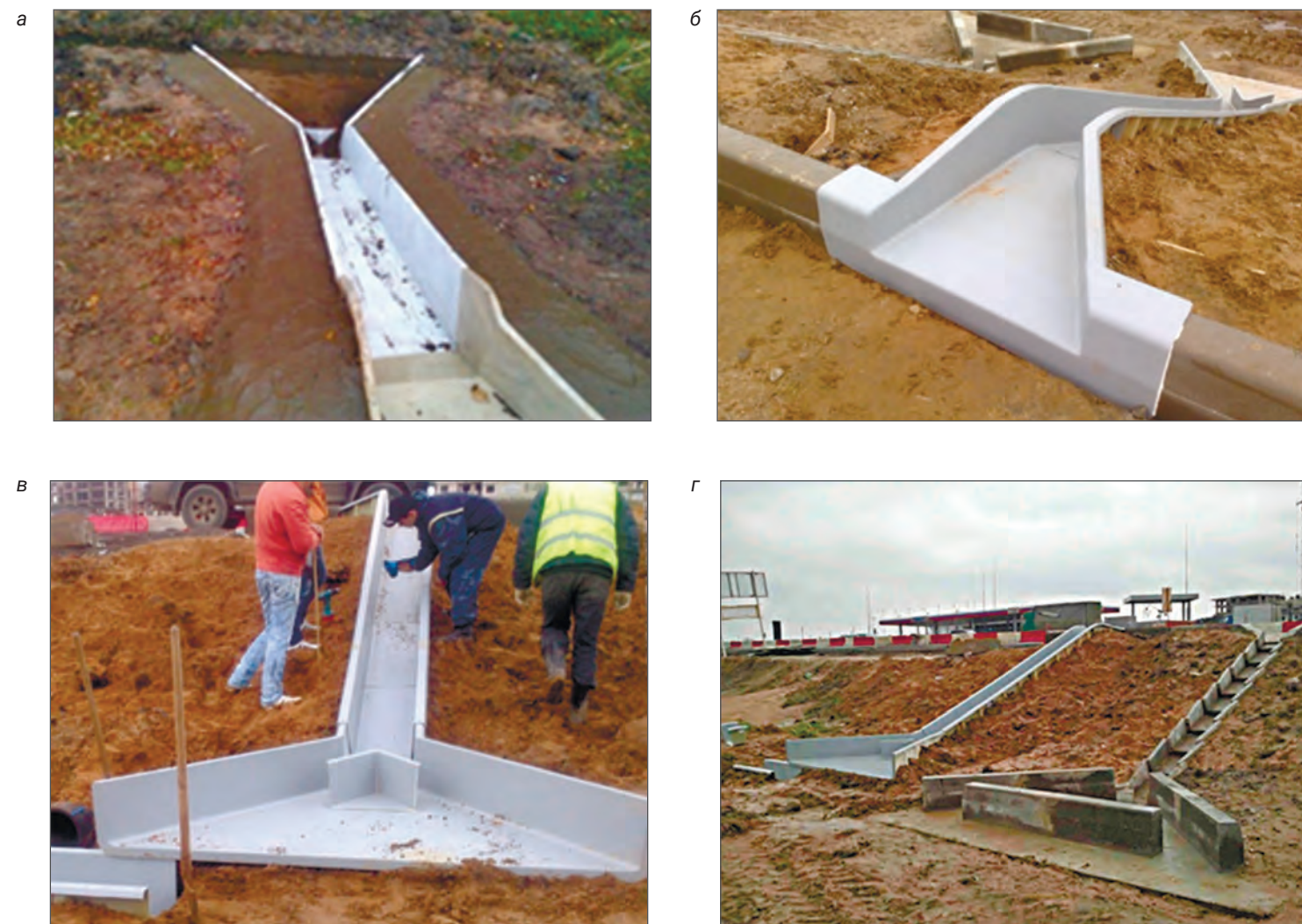
Рис. 4. Устройство опытных образцов организованного дорожного водоотвода конструкции Моно-Строй на трассе М-11: а, б, в — с композитными лотками; г — с композитными и бетонными лотками
