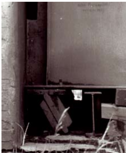
Рис. 1. Пролетное строение моста через р. Дон уперлось в шкафную стенку. Наклонное положение опорной части. 1995 год
