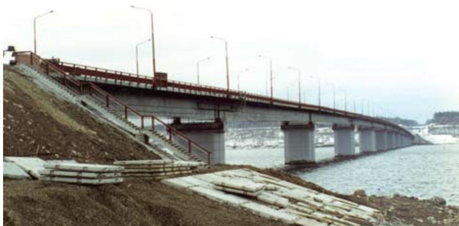
Рис. 4. Мост через р. Чусовую на автодороге Пермь — Березняки после восстановления насыпи и устройства противооползневой армогрунтовой системы
