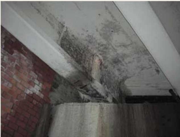
Рис. 39. Протечки сквозь строповочные отверстия балки, продукты коррозии бетона и арматуры
