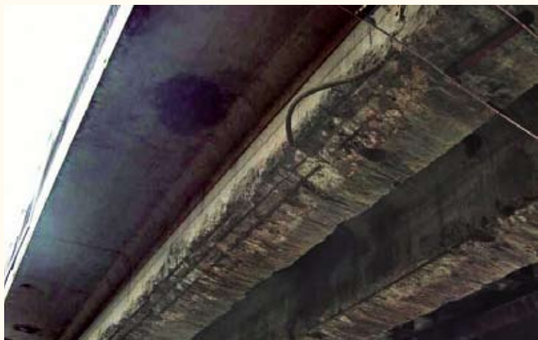
Рис. 47. Путепровод над Ленинским проспектом. Последствия ударов от негабаритного автотранспорта
