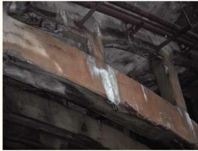
Рис. 40. Следы значительных протечек, выщелачивание бетона, оголение и коррозия арматуры
