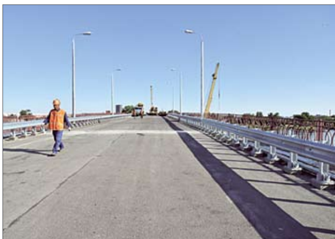
Мост в створе ул. Соликамской через р. Кривая Болда, г. Астрахань, до и после ремонтных работ
