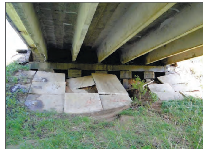
Фото 4. Вид снизу на пролетное строение до ремонта
