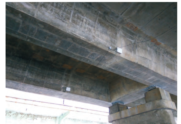
Рис. 13. Установка датчиков мониторинга на главные балки пролетного строения в поврежденных сечениях моста
