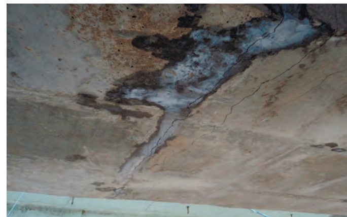
Рис. 12. Мост на ЦКАД. Сетка сквозных трещин в нижнем поясе главных балок при движении первого пролета
